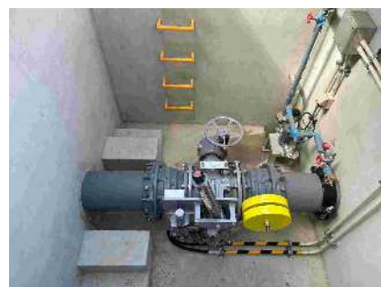
瀬戸調整池緊急遮断弁
