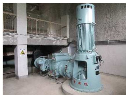
三野浄水場第5水源4号取水ポンプ
