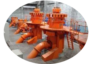
浄水場の効率運転による省エネルギー化に努めています
